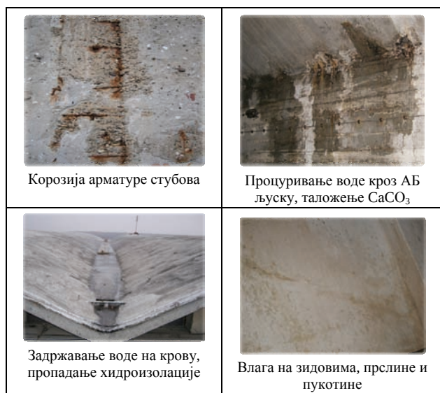
Слика 4.-видљива оштећења
