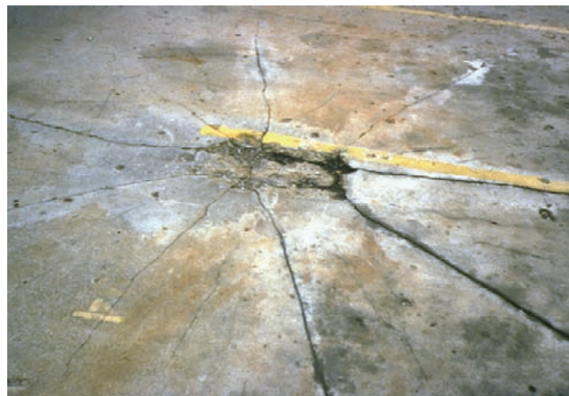
Slika 1. Oštećenja na ploči kao posledica probijanja
