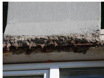
Slika 9. Korozija armature i otkinuti deo elementa
