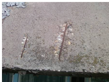
Slika 8. Mali zaštitni sloj betona, vidljiva armatura i betonska gnezda na elementima lođa
