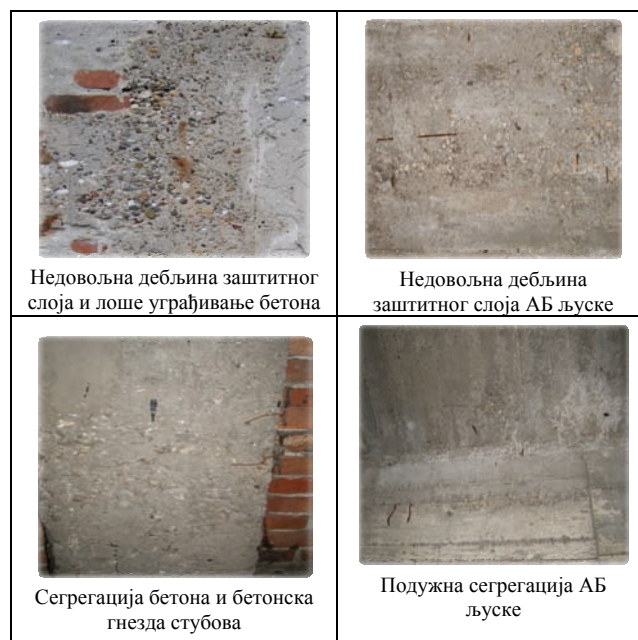
Слика 3.-видљиви дефекти
