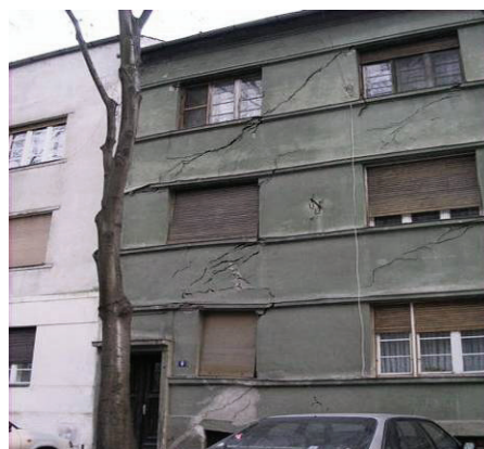
Slika 1. Prsline usled sleganja srednjeg dela zgrade
