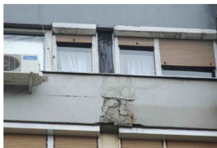
Slika 11. Otpadanje maltera sa parapeta
