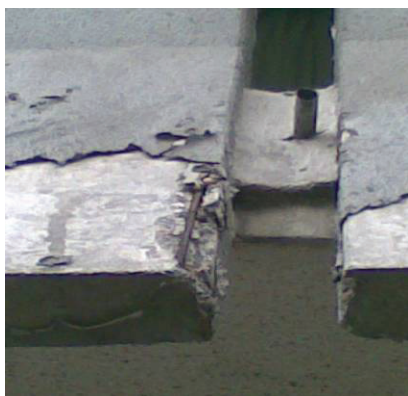
Slika 4. Otpadanje delova betona i korozija armature
