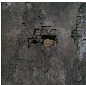
Slika 14. Mehaničko oštećenje zida
