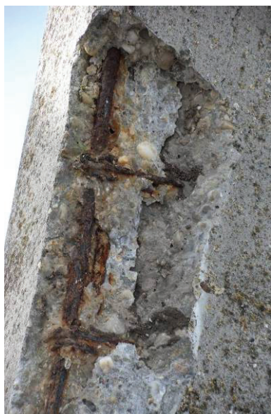
Slika 6. Korozija podužne armature i uzengija (vešaljka)
