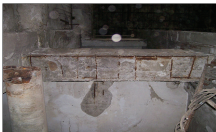
Slika 9. Mala debljina zaštitnog sloja i korozija armature
