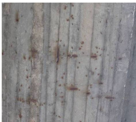
Slika 7. Nedovoljan zaštitni sloj betona, korozija vidljive armature (donja strana kolovozne ploče)
