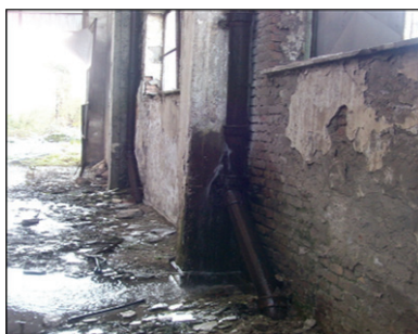
Slika 11. Oštećenja zida izazvana dejstvom vlage
