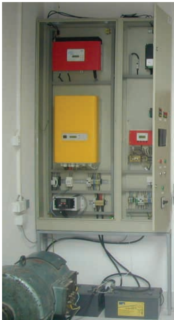
Slika 3. Izgled povezanih komponenti u komandnom ormanu.
