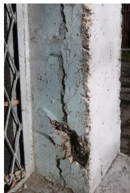
Slika 4. Otpadanje zaštitnog sloja betona
