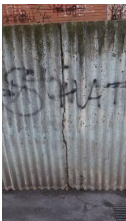
Slika 5. Pukotina na potpornom zidu
