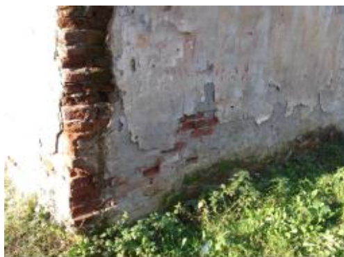
Slika 2. Oštećen malter u donjem delu zida i otpadanje delova opeka. Ljuspanje fasade i promena boje
