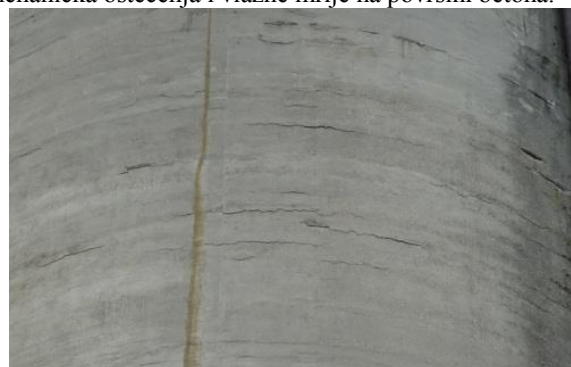
Slika 9. Prsline na mestu korozije armature, ljuskanje i otpadanje betona.
