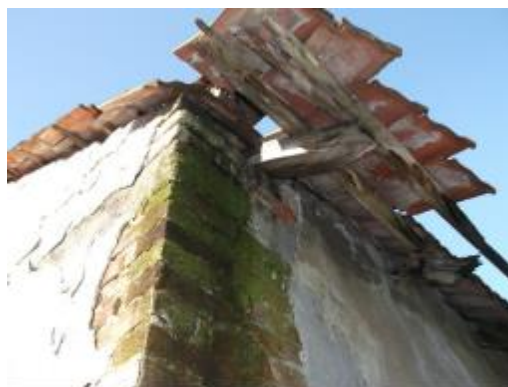
Slika 3. Otpadanje maltera, biološka korozija, pomeren crep
