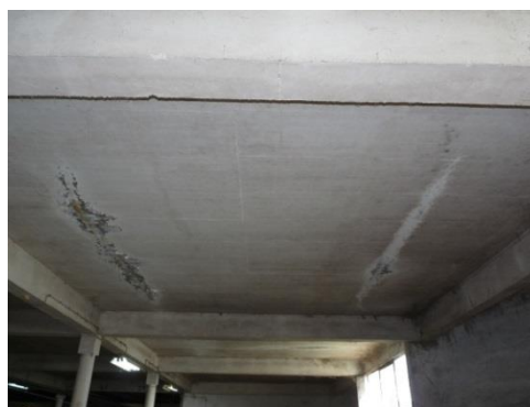
Slika 8. Procurivanje vode kroz krovnu ploču, zaprljan površinski sloj betona, korozija armature, ljuskanje i otpadanje zaštitnog premaza
