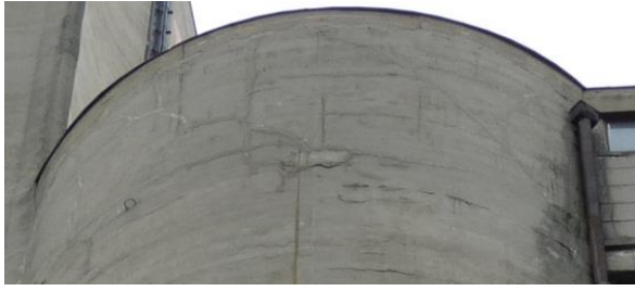
Slika 10. Vertikalne i kose prsline, korozija horizontalne armature, ljuskanje betona
