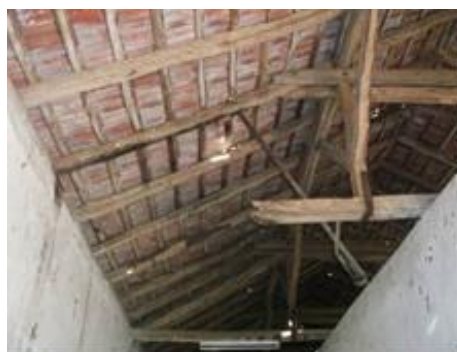
Slika 4. Gubitak zatege, potpuno truljenje, lom, krov prokišnjava, tragovi buđi na letvama i rogovima. Tragovi pokušaja sanacije zatege – improvizacija
