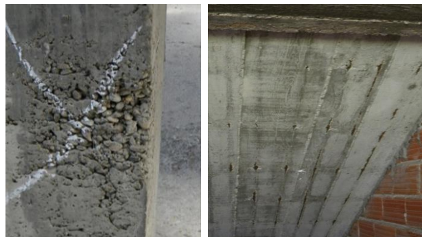
Slika 3.3. Betonsko gnijezdo na stubu i nedovoljna debljina zaštitnog sloja betona na stepenišnom kraku
