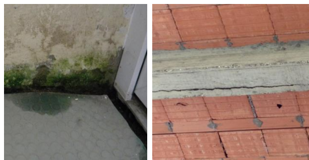
Slika 3.4. Biološka korozija i korozija armature greda
