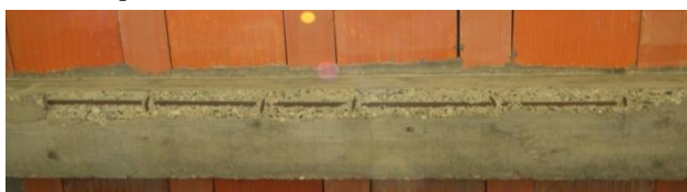
Slika 3.2. Odvaljena ivica betona na gredi
