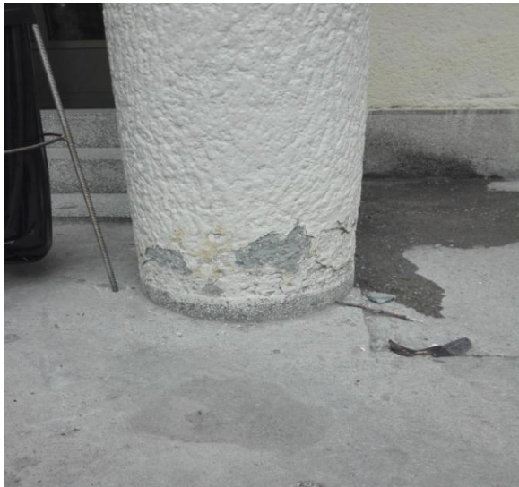
Слика 3. Љускање и отпадање завршне боје и малтера
