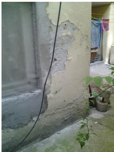
Slika 2. Pojava kapilarne vlage u zidu u osi 3
