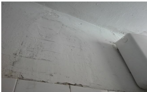
Слика 2. Оштећење услед влаге
