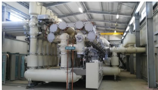
Slika 6. 400kV SF6 postrojenje
