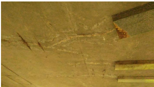
Slika 2. Korozija betona i armature
