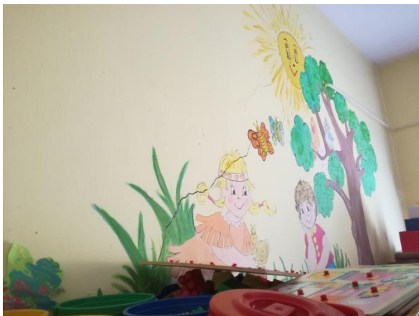
Slika 2. Pukotina kroz ceo poprečni presek zida, uzrok neujednačeno sleganje
