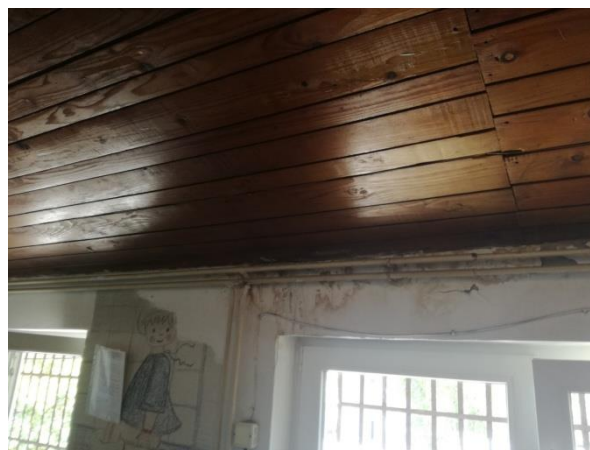
Slika 3. Vlaga na zidu, posledica prokišnjavanja krova kod oluka
