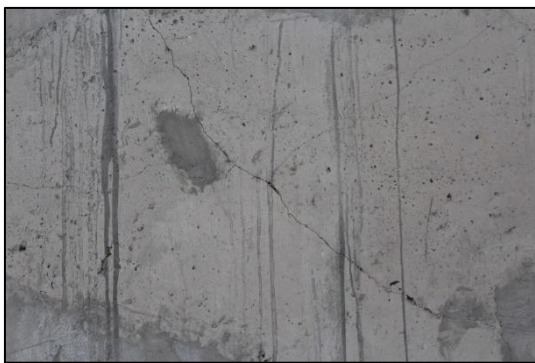
Slika 5. Prsline kose orijentacije na zidovima
