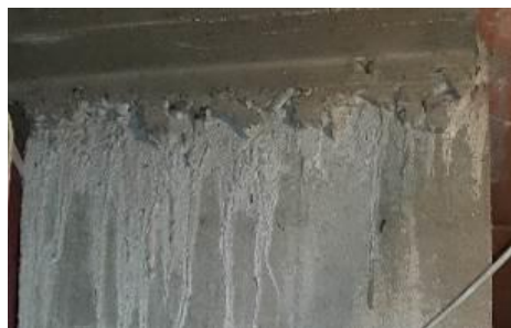
Slika 2. Nepravilno izveden prekid i nastavak betoniranja stuba i grede u suterenu
