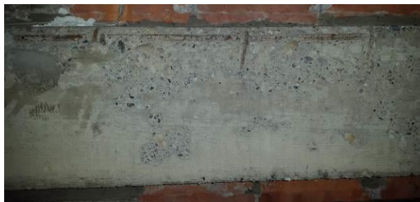
Slika 1. Detalj grede – odlomljene ivice, otkrivena armatura sa površinskom korozijom
