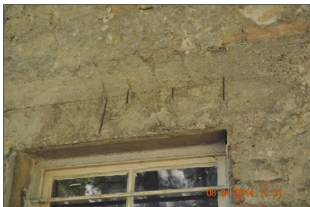
Слика 5. Трошан малтер, заштитни слој недовољне дебљине на АБ надпрозорној греди
