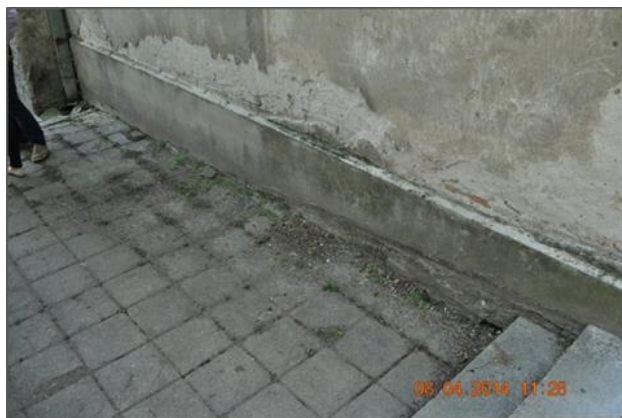
Слика 4. Одвојен заштитни тротоар од фасадног зида - слегање тротоара, мрље од влаге, трошан малтер, биолошка корозија
