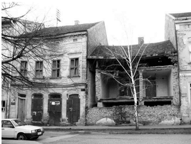
Slika 2. Porušeni stambeni objekti na odabranoj lokaciji
