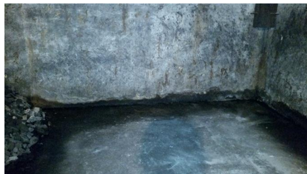
Slika 2. Prodiranje vode u objekat usled odizanja ploče
