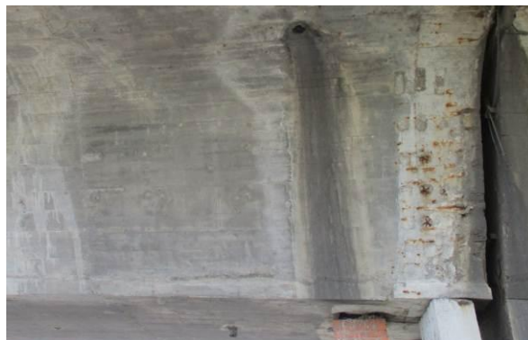
Slika 9. Korodirale šipke armature i korozija kotvi
