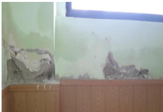
Slika 7. Vlaga, ljuaskanje i krunjenje maltera u zidovima i pilasterima sale
