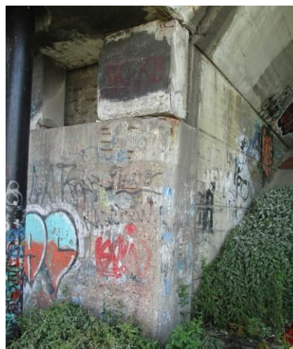
Slika 10. Oštećenja na betonskom ležištu i obalnom stubu
