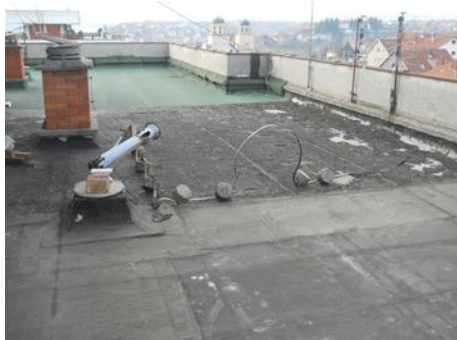
Slika 5. Izgled krovne terase i parcijalna sanacija različitim hidroizolacionim materijalima
