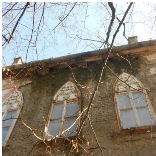
Slika 4. Vidljive zelene mrlje, otpao fasadni malter sa oštećenim fugnama, istrunulo drvo, ljušpanje farbe...
