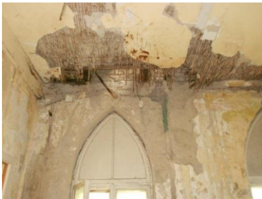
Slika 7. Oštećena drvena međuspratna konstrukcija, vidljive ogoljene cigle, ljuštenje završnog sloja farbe
