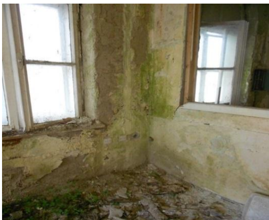
Slika 6. Usled oštećenja krova i međuspratne konstrukcije dolazi do slivanja vode niz zid i pojave zelenih mrlja sa odvajanjem maltera od zida i pojava sitnog rastinja
