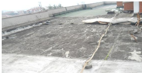
Slika 2. Oštećena hidroizolacija na krovnoj terasi
