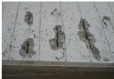
Slika 4. Bubrenje armature i otpadanja zaštitnog sloja betona na atici svetlarnika
