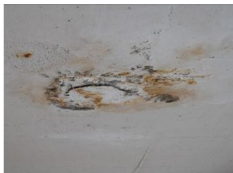
Slika 3. Procurivanje vode kroz ploču svetlarnika i korozija armature
