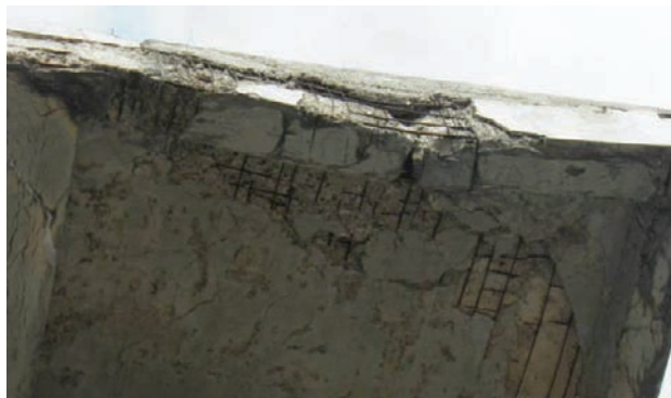
Slika (III-3): Oštećenja na koti + 24,3 m
