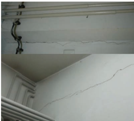
Slika br 5 i 6.- Prsline i pukotine na spoju dva elementa, armiranobetonske grede i zidanog zida
