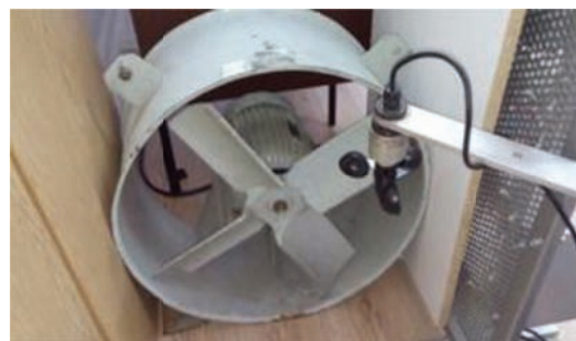
Slika 8. Senzor (anemometar) i actuator (motor sa ventilatorom)
