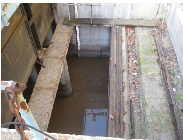
Slika 3. Kolektor u okviru crpne stanice
