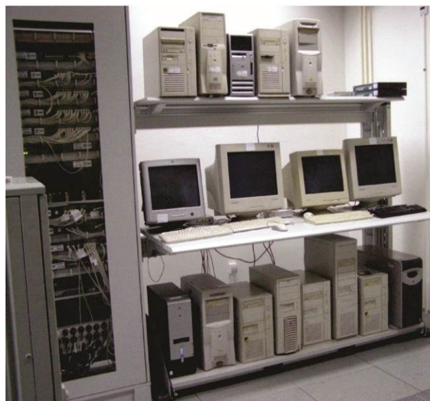
Slika 1. Pogled na server salu RGZ
