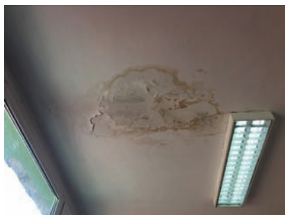
Slika 5. Fleka od vode i ljuštenje boje kao posledice prokišnjavanja krovne konstrukcije usled dejstva atmosferilija
