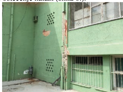
Slika 6. Odvajanje maltera i boja na fasadi usled dejstva atmosferilija i mraza na mestu prekida olučne instalacije
