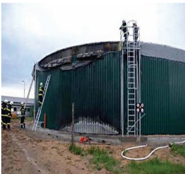
Slika 1. Požar na fermentoru izazvan udarom groma 2011 u Češkoj Republici (Travniček P., Kotek L., 2015)
