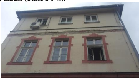
Slika 3. Oštećen fasadni venac
