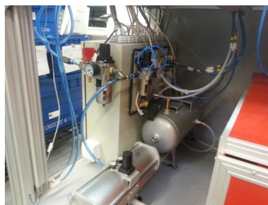
Slika 5. Elementi pneumatskog kola postavljeni na ispitnu stanicu
