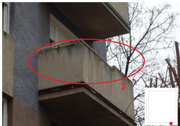
Slika 5. Tragovi curenja vode i raslojavanje završne obrade u gornjim delovima usled vlage i dejstva mraza
