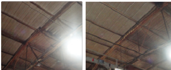
Slika 7 i 8- Glavni nosači zahvaćeni korozijom
