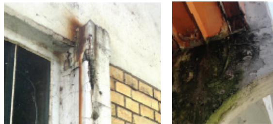
Slika 9 i 10– Oštećenja na spoljašnim elementima
