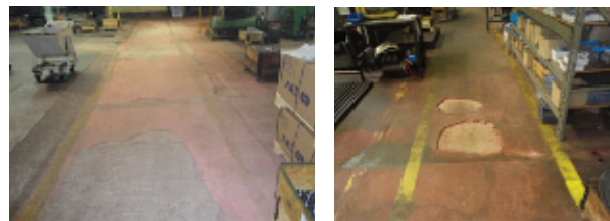
Slika 11 i 12 – Oštećenja podne ploče
