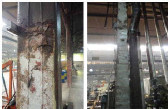
Slika 5 i 6 – Oštećenja stubova
