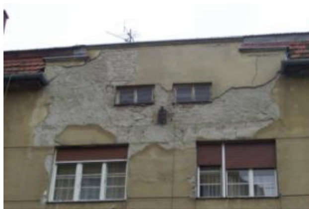
Slika 6 – Oštećenja na fasadi
