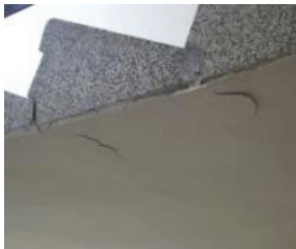
Slika 5 – Montažno, konzolno stepenište, ljuskanje dekorativnog premaza
