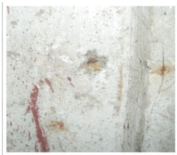
Slika 6 – Nedovoljna debljina zaštitnog sloja betona
