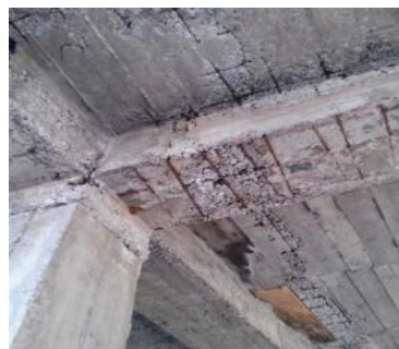
Slika 4. Zona segregacije, korozija armature i betonska gnezda
