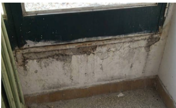
Slika 5. Prodor vlage kroz slojeve ravnog krova (ravan krov je veće visine od poda hodnika) ljuaskanje površinskog sloja, mrlje od vlage, trošan malter
