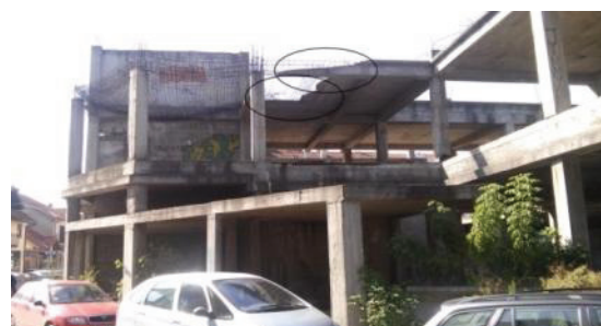
Slika 5. Neadekvatan prekid betoniranja
