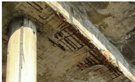
Slika 7. Korozija armature i otpadanje zaštitnog sloja
