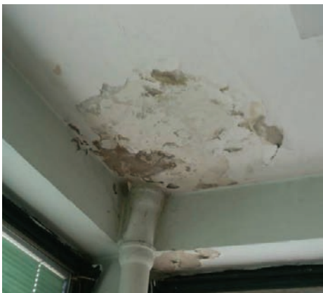
Slika 4. Oštećenje usled prodora vlage kroz ravan krov, ljuaskanje površinskog sloja, mrlje od vlage
