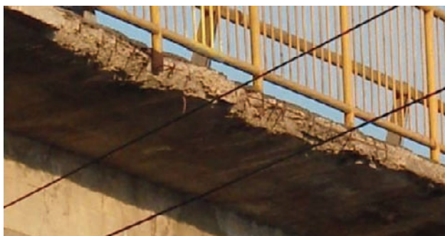
Slika 6. Odvaljen beton bočne ivice i korozija armature
