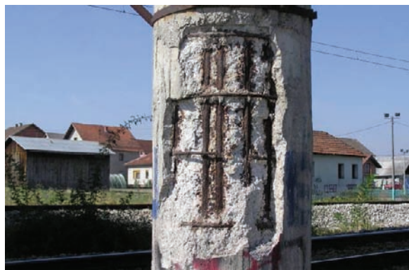
Slika 8. Korozija armature i uzengija stuba
