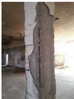
Slika 9. Odvaljena ivica betona
