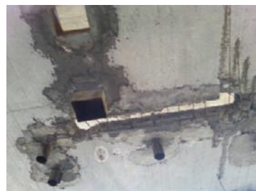
Slika 8. Nepravilno izvedeni otvori
