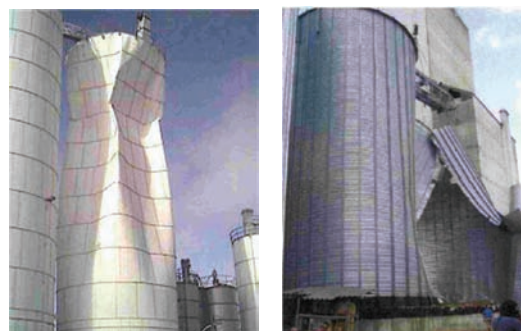
Slika 3. Oštećenja metalnih silosa usled protočnih problema
