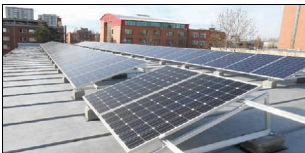
Slika 3. FN elektrana 16,3 kWp [7].
