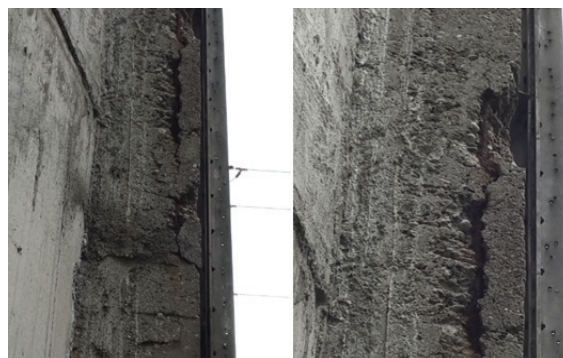
Slika 6- Korozija armature i otpadanje zaštitnog sloja betona
