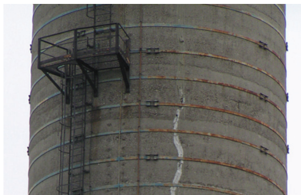
Slika 5- Mali zaštitni sloj betona, loše izvedeni nastavci betoniranja, korozija zaštitne ograde i penjalica
