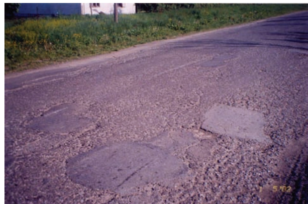
Slika 6. Snimak oštećenja površine kolovoza ( km 31+934 )
