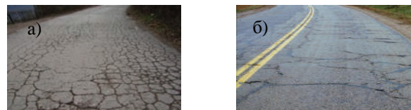
Слика 2: а) Пукотине услед замора; б) Блок пукотине
