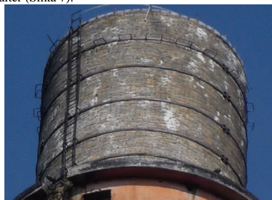
Slika 7- Tragovi eflorescencije, ispale opeke, ispran malter iz spojnica i rastrešen nadzidak
