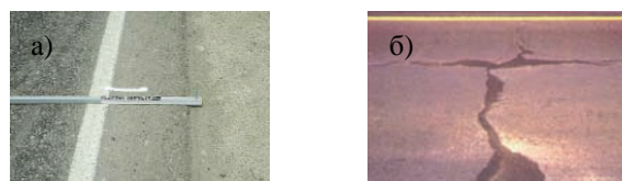
Слика 8: а) Слијегање банке; б) Цурење и пумпање воде
