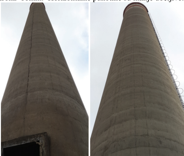
Slika 4- Vertikalne i horizontalne prsline u osama jedan i dva plašta
