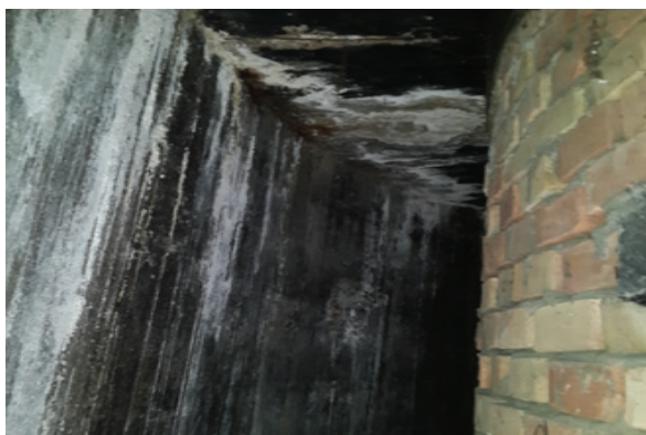
Slika 8- Nataloženi krečnjak, korozija armature otpadanje zaštitnog sloja betona
