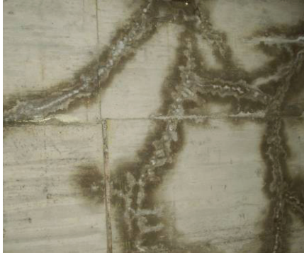
Слика 3.4 Прслине услед пластичног скупљања бетона са доње стране АБ плоче
