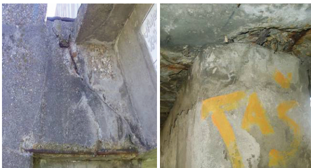
Slika 10 i 11. Korozija armature, pukotine, odvajanje betona i betonska gnezda
