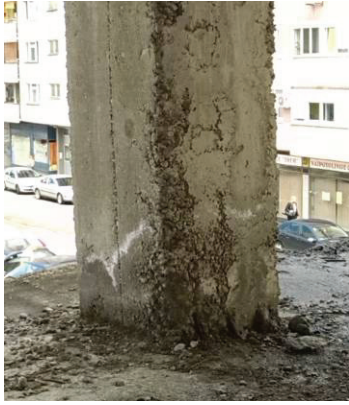
Слика 3.3 Бетонско гнездо и сегрегација стуба
