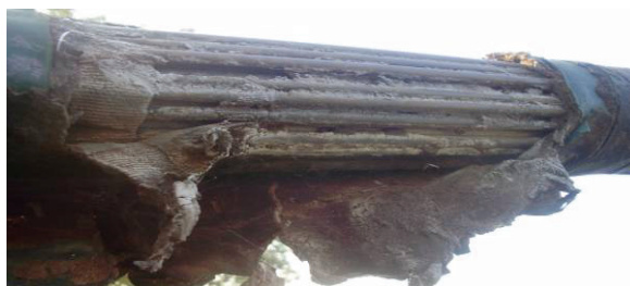
Slika 8. Oštećenje zaštitnog omotača gl. kabela
