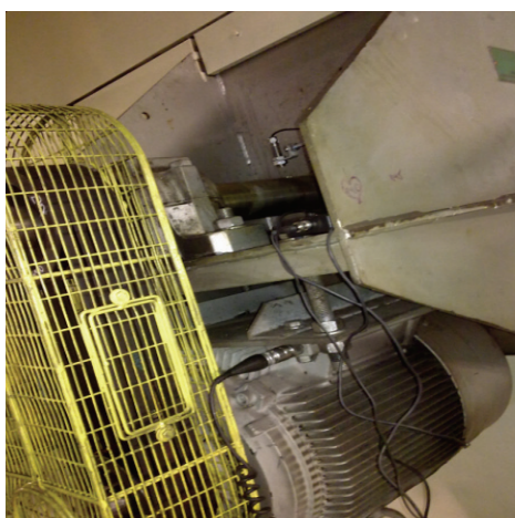
Slika 6: Recirkulacioni ventilator 37kW
