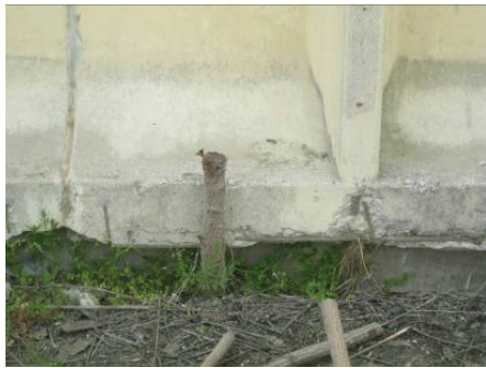
Слика 3.3. Недовољна дебљина заштитног слоја бетона и кородирала арматура на доњем делу фасадног елемента
