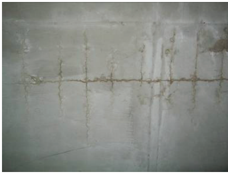
Слика 3.2. Пукотине на доњој страни АБ међуспратне плоче анекса настале услед корозије арматуре и прекида бетонирања
