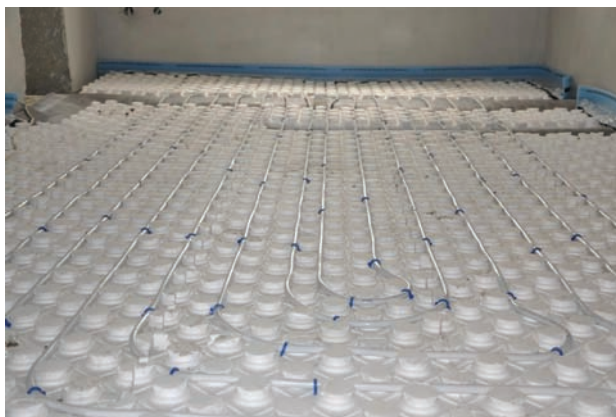
Slika 3. Instalacija podnog grejanja
