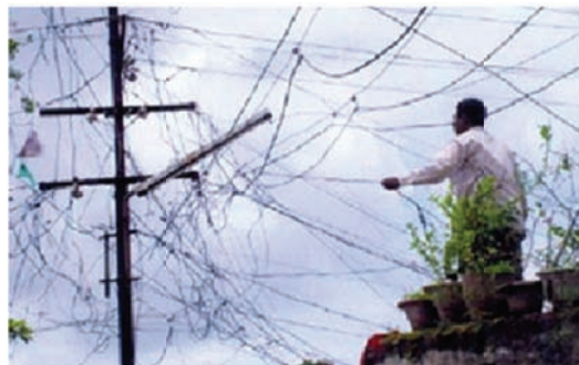
Slika 3 – Jedan od postupaka krađe električne energije (izbegavanje električnog brojila)
