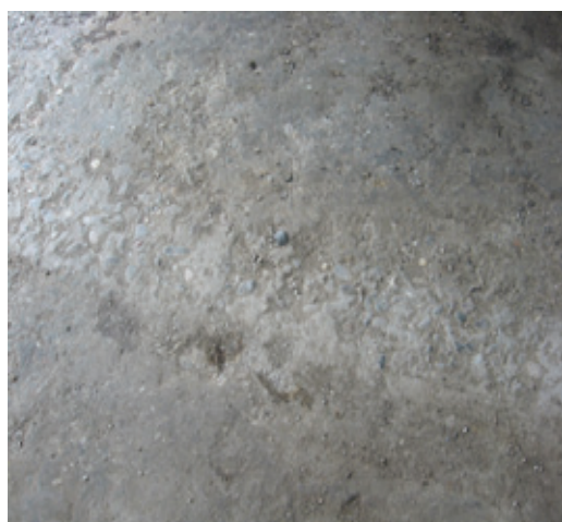
Slika 6: Erozija usled habanja – pod u radioničkoj hali
