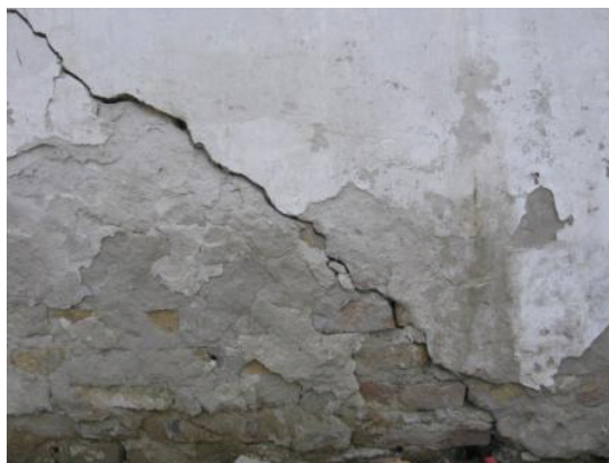
Slika 14. Pukotina u zidu
