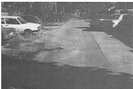
Slika 6 Prikaz oštećenja na kolovozu udarna rupa
