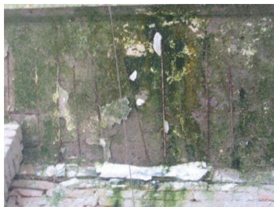
Slika 11. Nedovoljna debljina zaštitnog sloja, korozija armature, biološka korozija – krovni pokrivač
