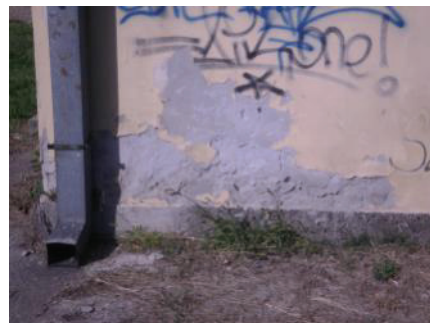
Слика 5. – Биолошка корозија и љускање завршног фасадног слоја
