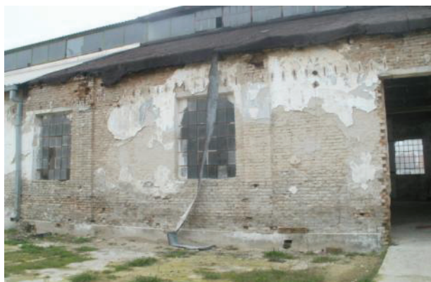
Slika 9. Otpadanje delova fasade, oštećenja krovnog pokrivača i oluka
